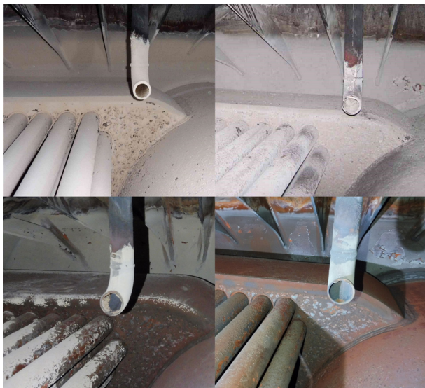
Abb. 3 Dampfkessel, wasserseitig, Bereich des Speise-wasser-eintritts – Dokumentation der erfolgreichen Inbetrieb-reinigung; Schaubilder aus den Jahren 2020 (Start der Maßnahme, o. li.), 2021 (o. re.), 2022 (u. li.) und 2023 (Ende der Maßnahme, u. re.)
