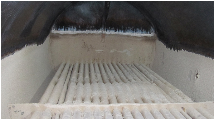
Abb. 1 Dampfkessel, wasserseitig – innere Revision nach Härteeinbruch
