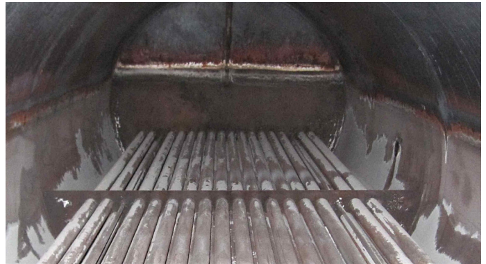
Abb. 2 Dampfkessel, wasserseitig – innere Revision nach Beendigung der polymerbasierten Inbetriebreinigung
